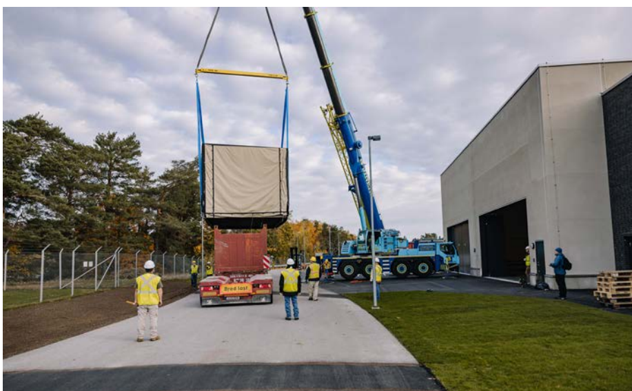
I oktober förra året skedde leveransen av simulatören. Sedan dess har FMV säkerställt installation och testning. Foto: Jesper Moldvik.
